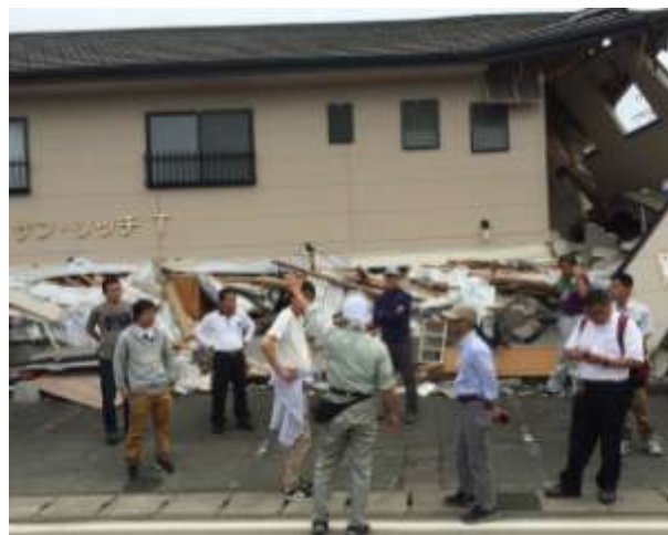
△1階が倒壊したアパート前で説明を聞く
